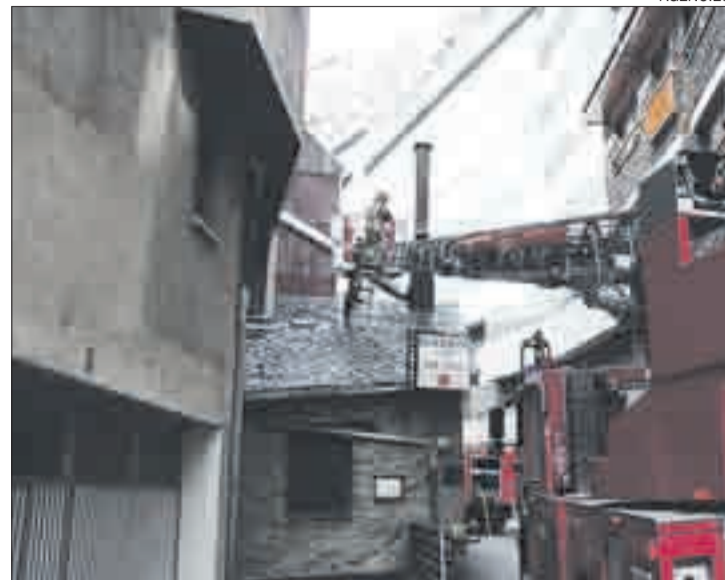
Els efectius dels bombers treballant en la xemeneia afectada pel foc.
